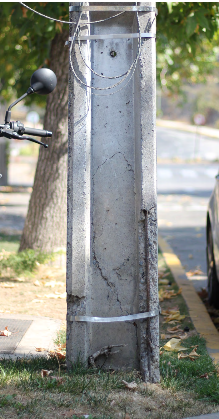
Fig. 5: Poste de distribución eléctrica en Lo Barnechea con su enfierradura corroída en la sección inferior.
