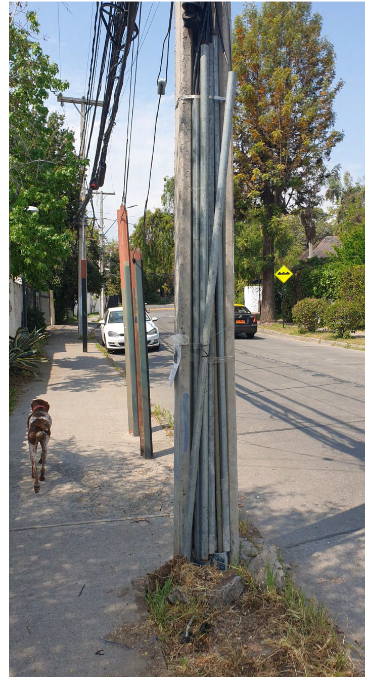
Fig. 42: Múltiples conductos con cableado bajando por el costado de un poste en la comuna de Vitacura.
