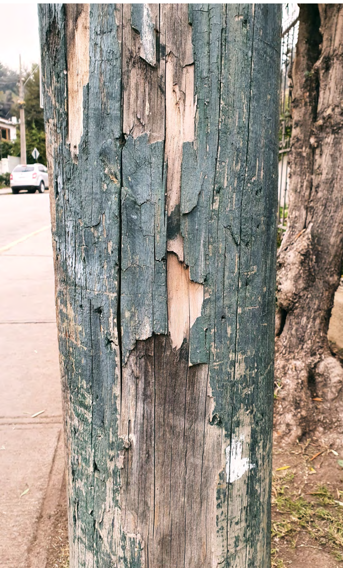
Fig. 9: Poste de madera en la comuna de Providencia que presenta daños en su superficie por la exposición a los elementos.
