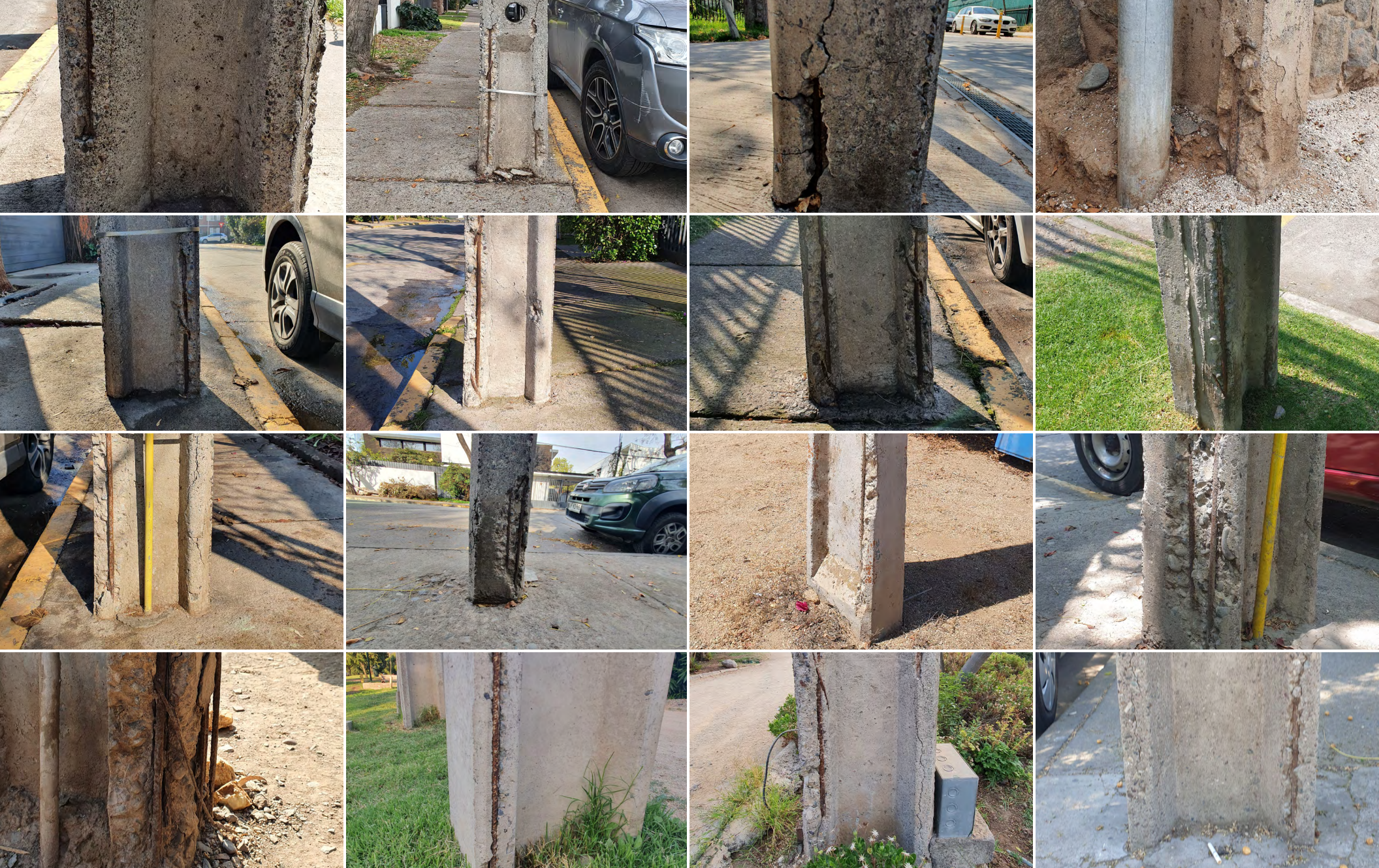
Fig. 31: Postes de la Región Metropolitana y la Región de Valparaíso con daños presentados en los primeros 50 cm que sobresalen del suelo, asociados a cargas dinámicas.
