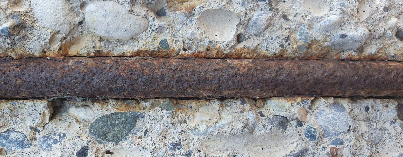
Fig. 20: Vista horizontal de una enfierradura corroída.
