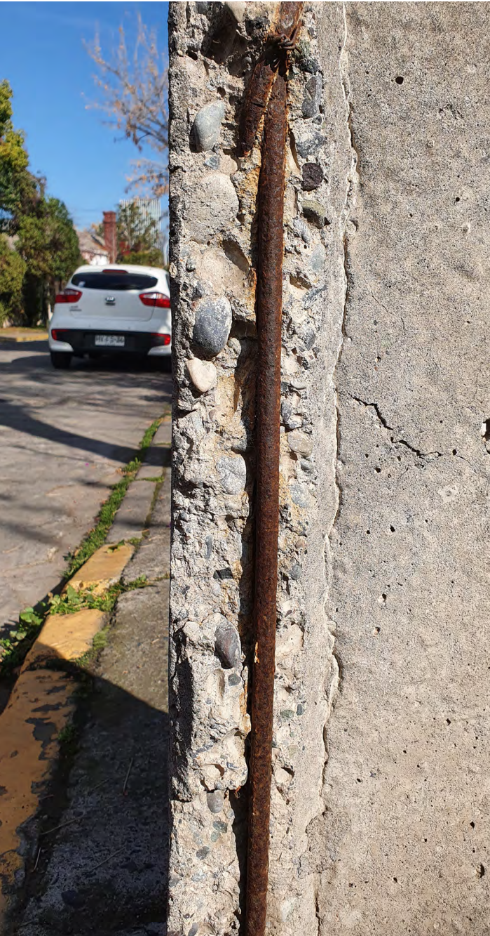
Fig. 27: Poste de distribución eléctrica en Providencia con su enfierradura corroída en la sección inferior.
