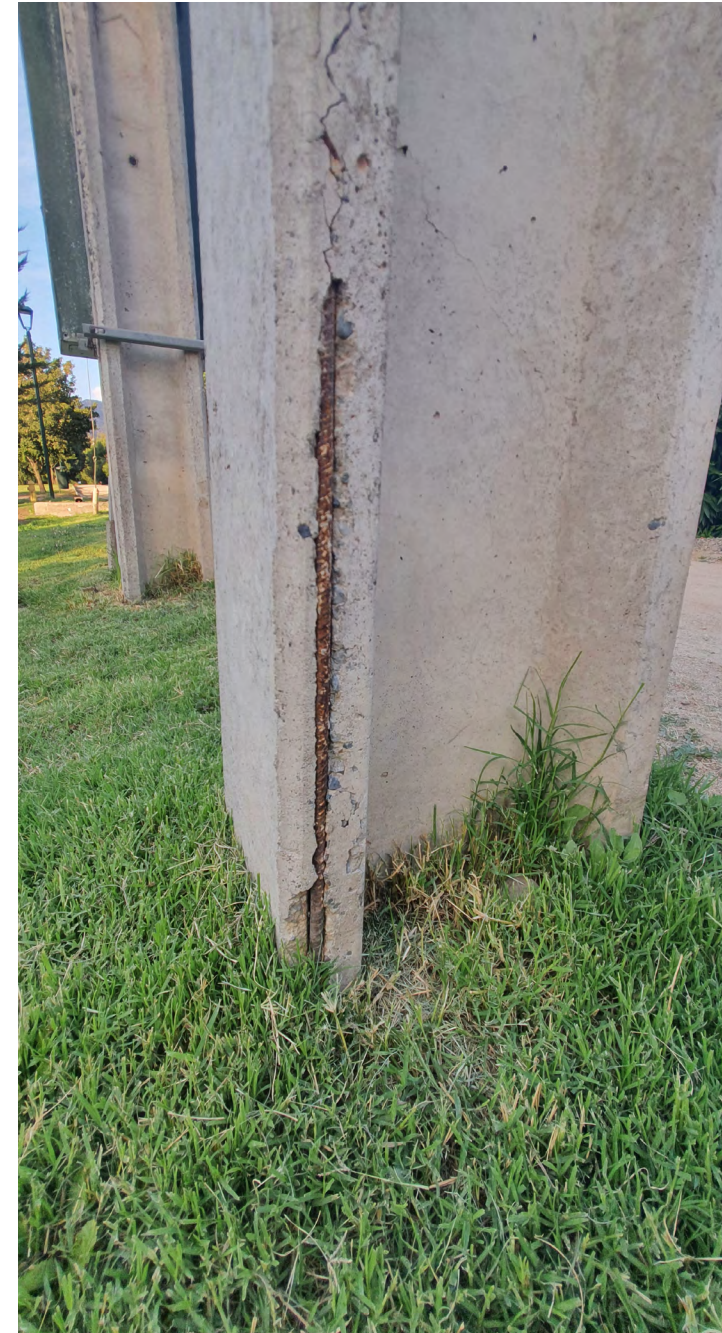
Fig. 35: Poste ubicado en un parque de Lo Barnechea frecuentado por perros. El color claro del poste evidencia que posiblemente fue instalado hace pocos años.
