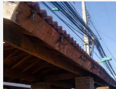
Imagen 25: Ganchos sin canaleta. Fotografía propia.
