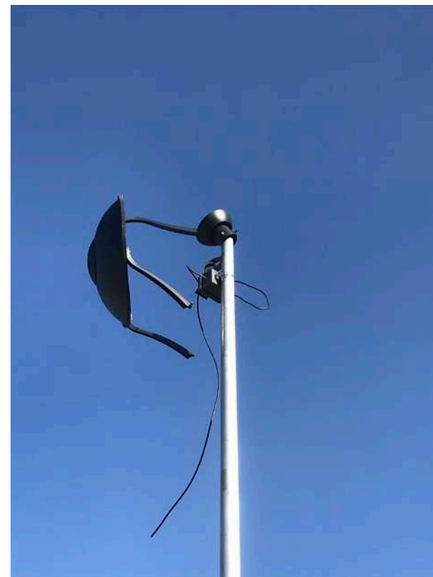
(Figura 10: Luminarias quebradas, 2020)
