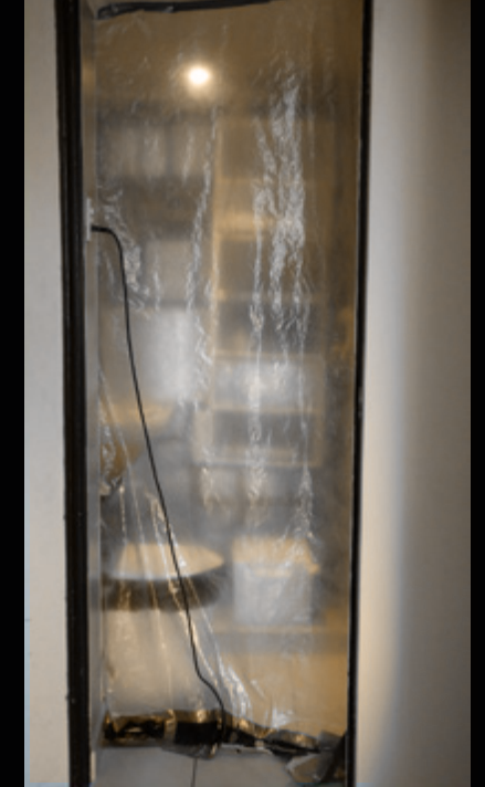
Adherir lona plástica transparente con cinta adhesiva a cielo, suelo y muro norte; entrada por costado derecho. Cable alargador conectado a enchufe de muro.
