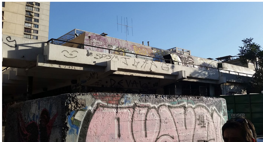
Grafitis y deterioro del hormigon y la estructura.
