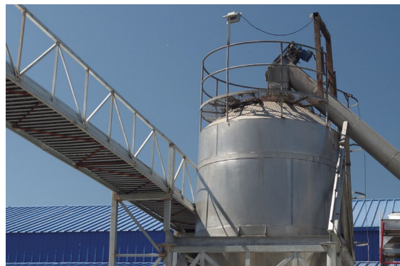
Silo donde se acopia y tritura el material de descarte que es enviado a la planta de Cal.
