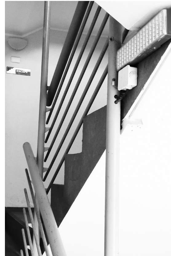
Observación caja de escala: luz de emergencia y señalética en acrílico. Ésta última no es visible en la oscuridad.
