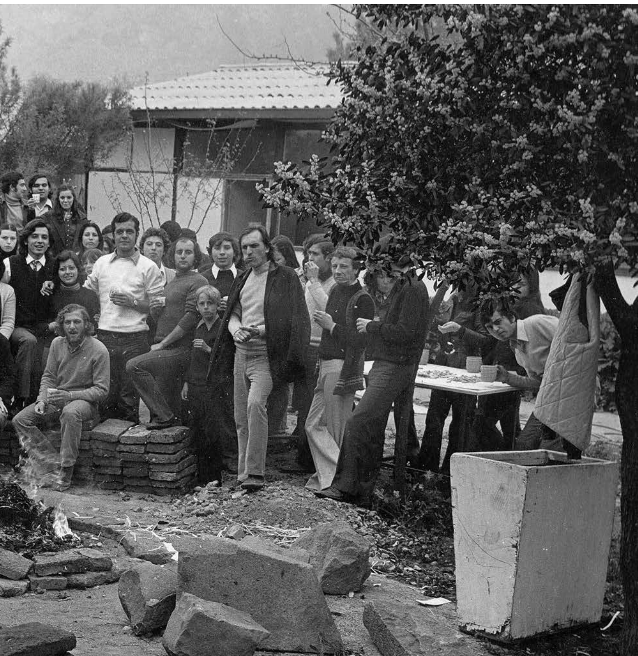
Fundación patio Escuela Diseño uc. Inicio de obras de construcción de bancos.
